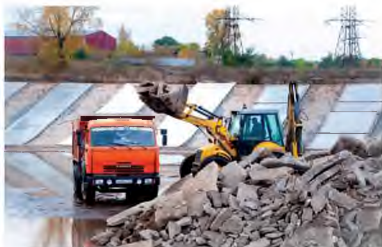
Во время ремонта демонтировано бетонное основание иловых карт объёмом более 40 тыс м 3
