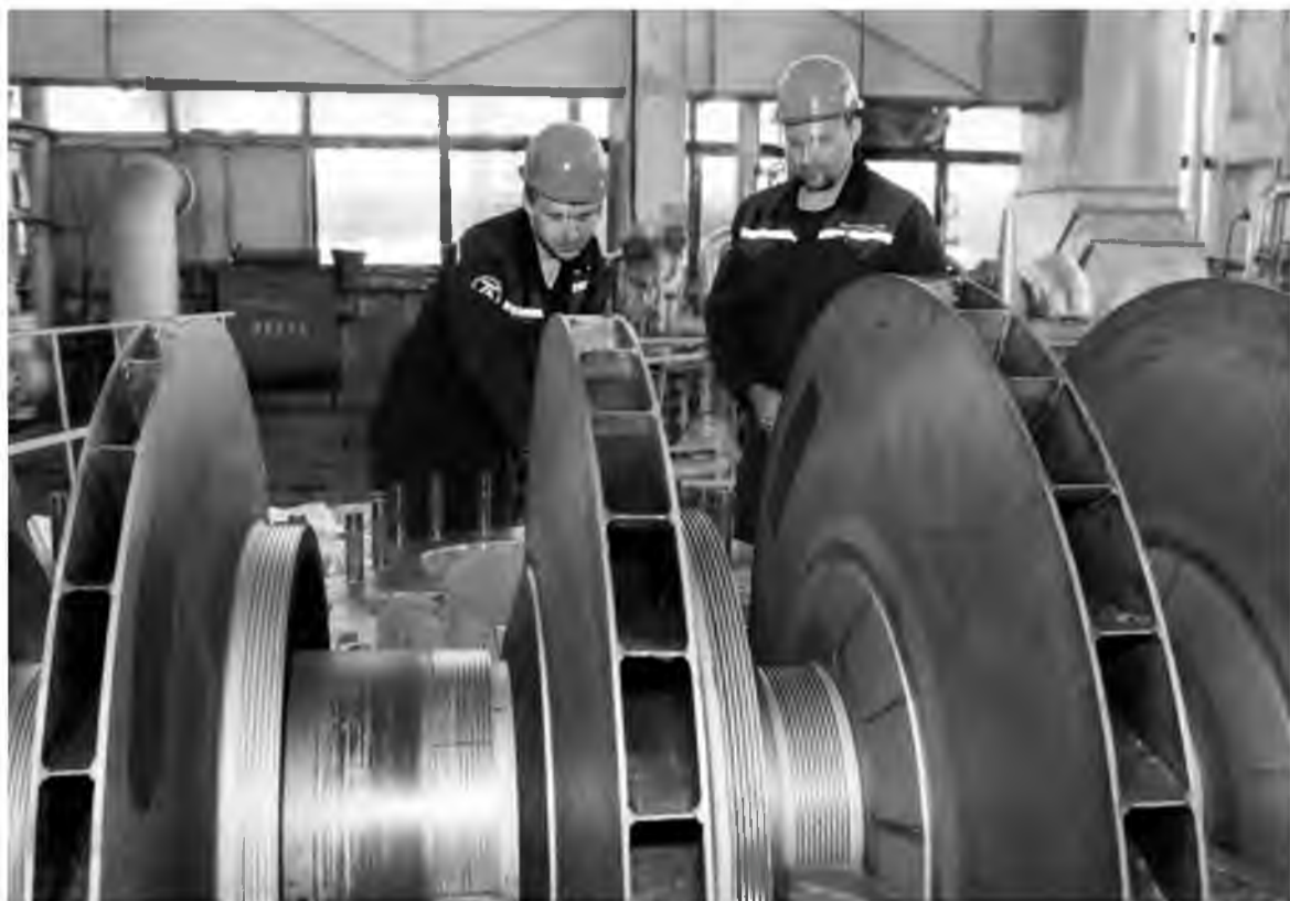
Цех №22: бригада Анатолия Кривошеца на отделении компрессии ведёт капитальный ремонт компрессора воздуха К-401
