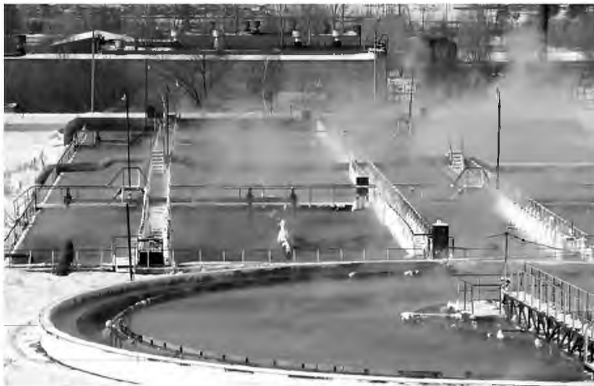
После реконструкции биологических очистных сооружений ОАО «Тольяттиазот» обеспечит повышенную чистоту воды, поступающей в Волгу
